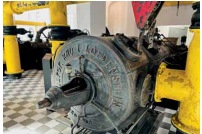
Fragment zachowanej instalacji
